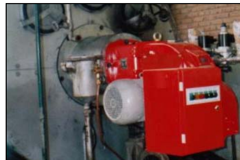
Figura 2. Quemador de gas natural de la caldera.
