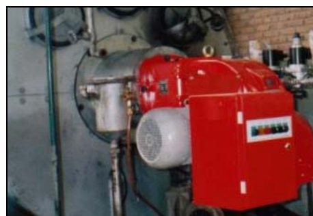
Figura 2. Quemador de gas natural de la caldera.
