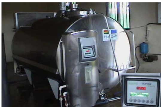
Figura 9. Tanque de enfriamiento en Ichoa (3,000 L)
