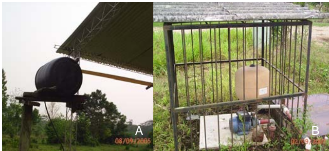
Figura 4. Salas de ordeño A) Vista del sistema de recolección de agua de lluvia B) Vista del pozo y bomba de agua.
