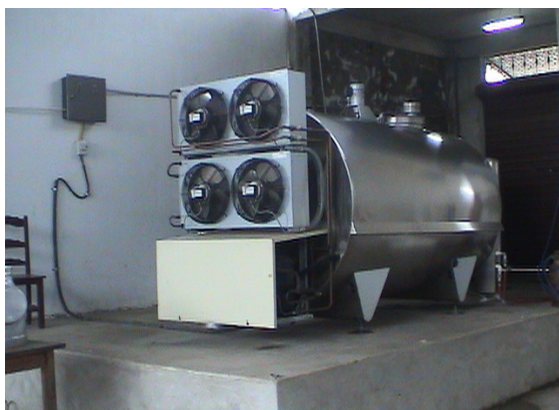
Figura 10. Tanque de enfriamiento en Entre Ríos (3,000 L)
