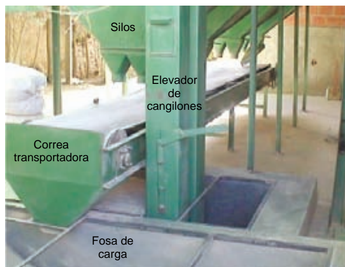
Figura 1. Fosa de carga, elevador de cangilones y correa transportadora, para carga y descarga del grano de quinua en 8 silos, cada uno de 12 t de capacidad.
