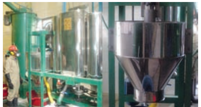
Figura 4. Sistema de limpieza por vía húmeda (izquierda); y vista frontal del centrifugador sin su cubierta superior (derecha), el cual opera en forma continua.
