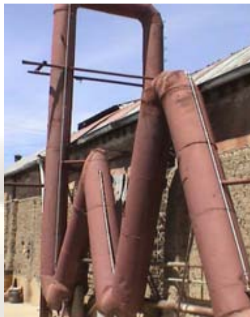
Figura 2 Vista parcial de la chimenea con sistema de trampa de agua
